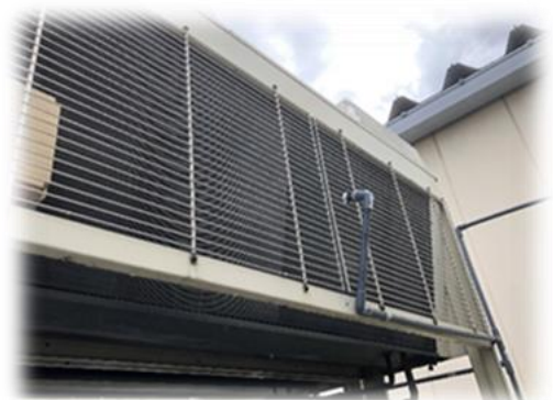
室外機に設置した自動御噴霧装置
